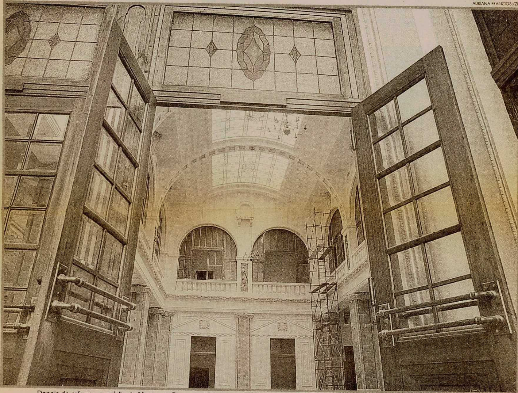
Depois da reforma, o prédio do Margs, na Praça da Alfândega, perdeu as goteiras e as infiltrações, companheiras fiéis por dezenas de anos
