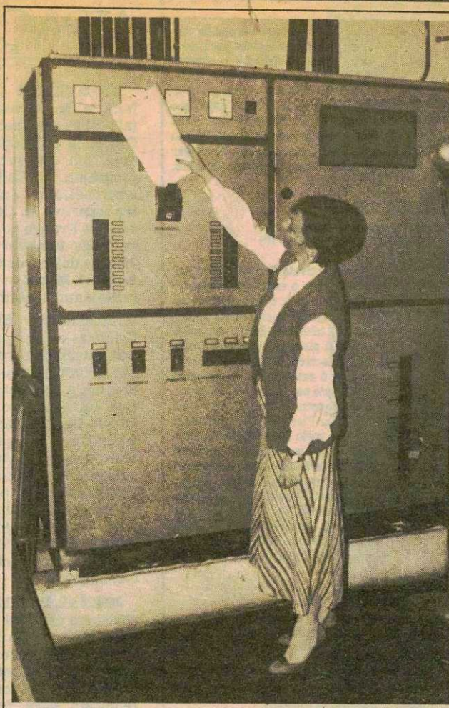
A diretora mostra o quadro elétrico geral do prédio
